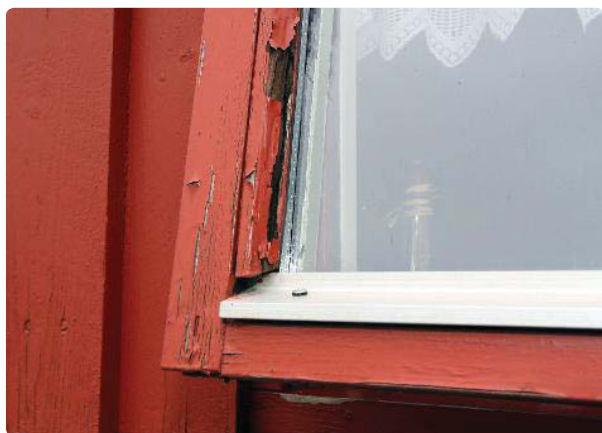
Øverst: Skader på fasadeplater. Nederst: Råte i vinduskarm Foto: Romerikes Blad
